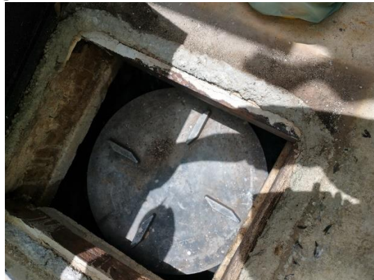
Imagen 5. Sistemas de almacenamiento del agua
